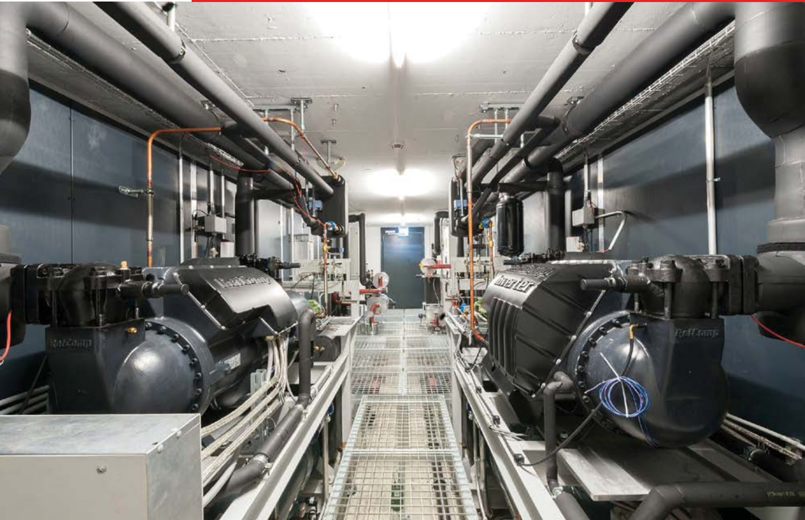
Luft-Wasser-Wärmepumpen mit 2 x 300 kW
